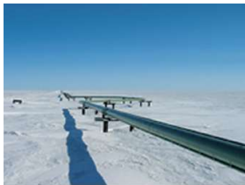
Обогрев протяженных трубопроводов
